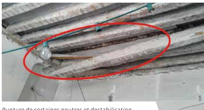
Rupture de certaines poutres et destabilisation de l'ensemble
